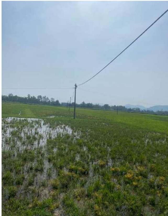
Tuyến điện 22 kV hiện trạng
