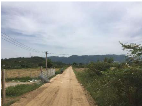
Hiện trạng đường BTXM thuộc thôn Liên Định, xã Nhơn Phong
