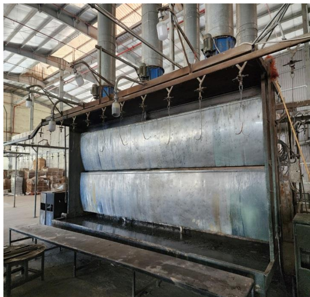
Bể chứa tuần hoàn
