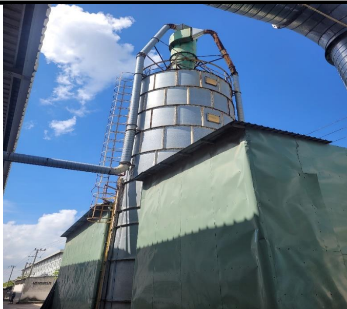
Hệ thống thu hồi bụi
