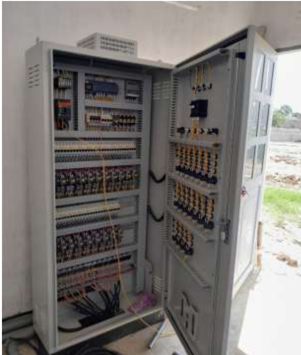
Tủ điện điều khiển HTXLNT
