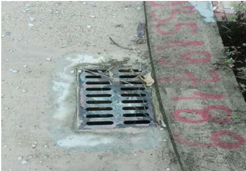
Nắp đan rãnh thoát nước
