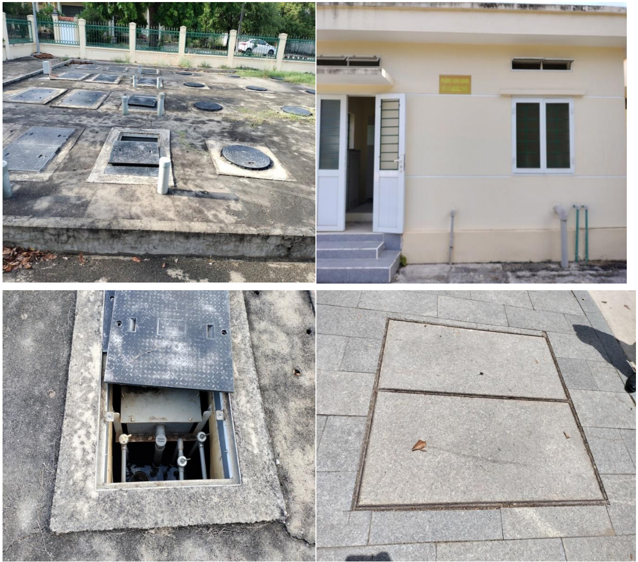
Hình 3.4. Hệ thống xử lý nước thải và hố ga đầu nối nước thải
