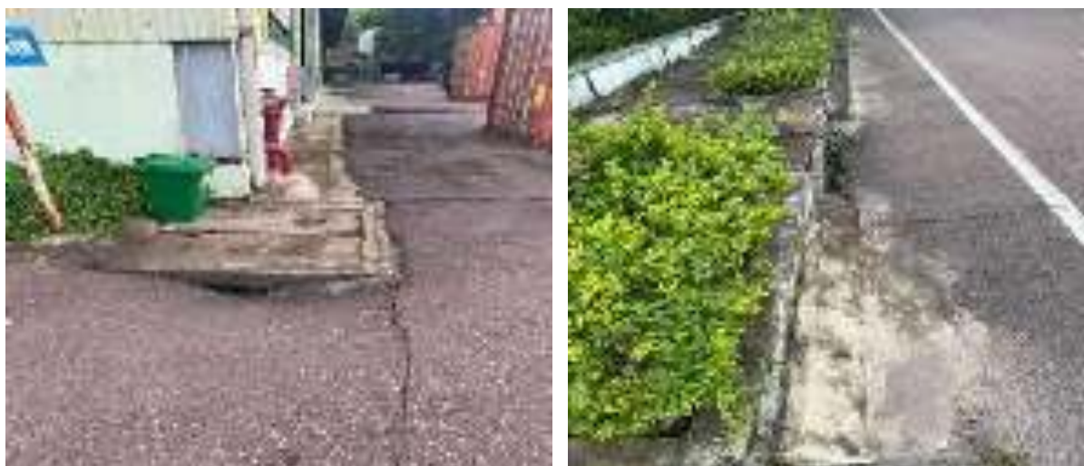
Hình 3.2. Mương thu gom và hố ga thu gom nước mưa của Công ty
