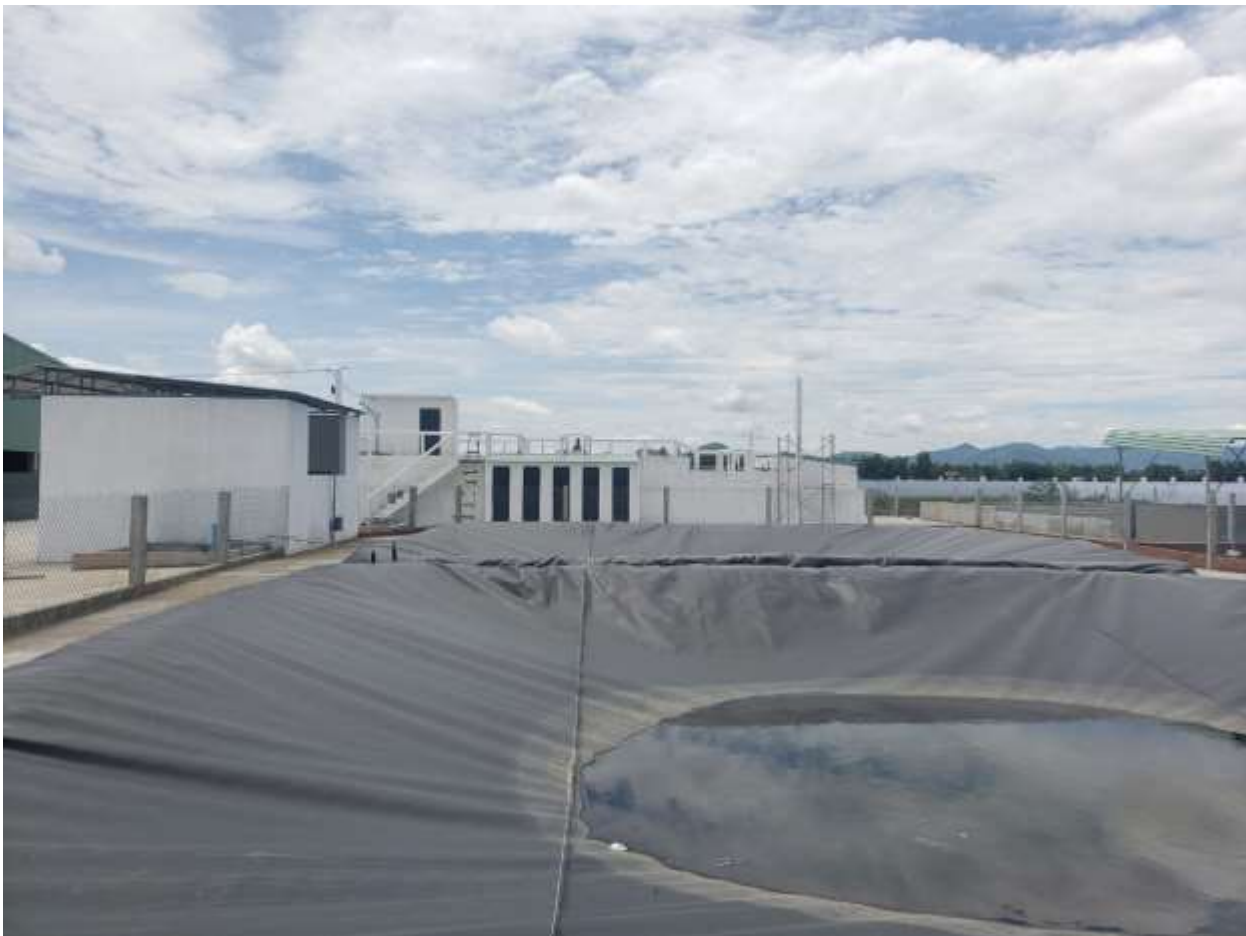
Hình 3. 9. Hàm biogas của HTXLNT
