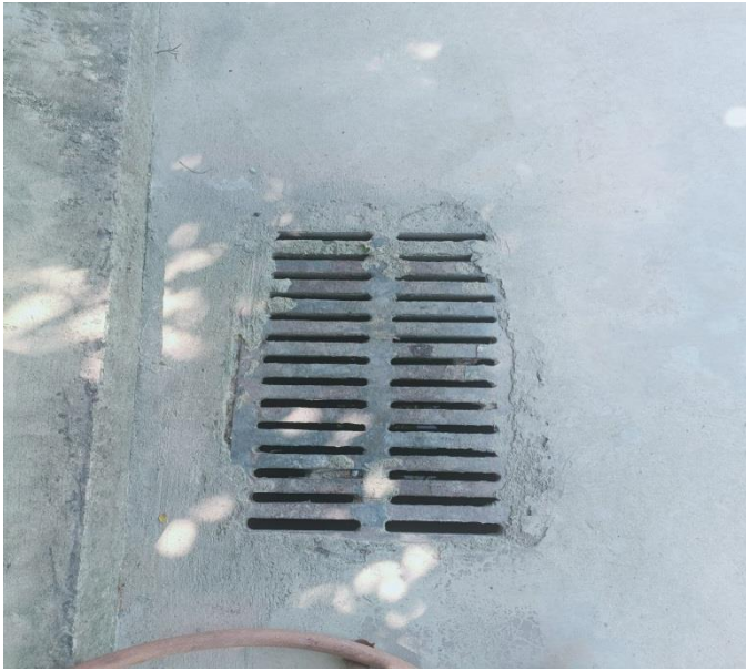
Hố ga thu gom nước mặt
