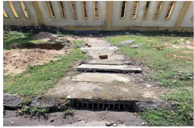
Hình 3.3: Điểm đầu nối nước mưa số 2 của nhà máy đầu với hạ tầng CCN
