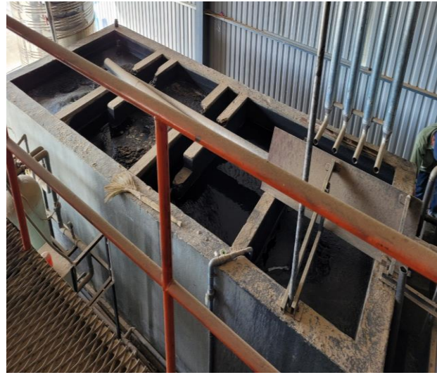
Hình: Bể xử lý xử lý khí thải
