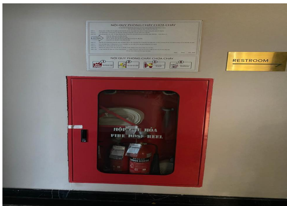
Hình 3.9. Các thiết bị phòng cháy chữa cháy và bảng nội dung tại Dự án
