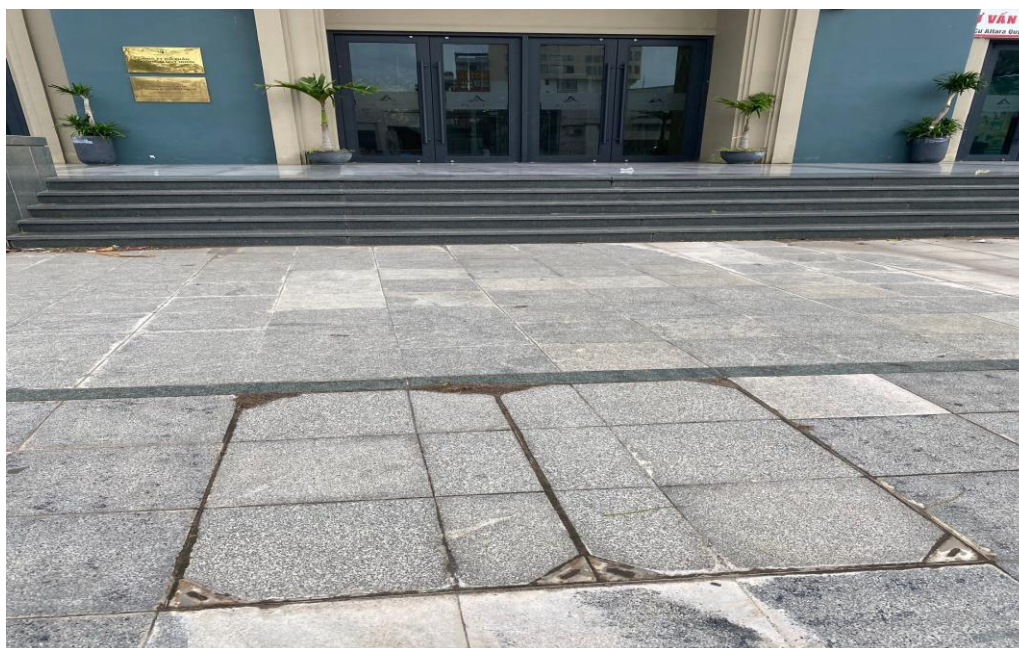
Hình 3.4. Hố ga thu nước mưa chung của Dự án
