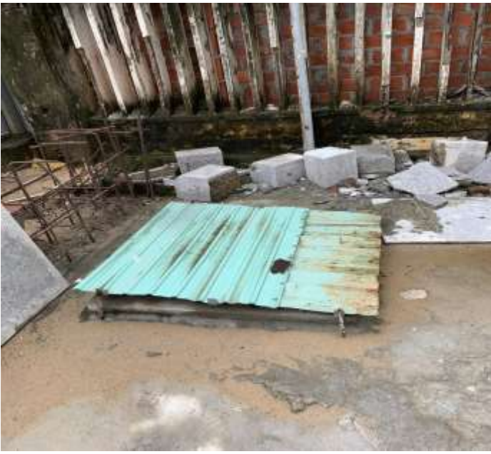
Hình 3.9. Bể thu gom dầu ra nước thải của HTXLNT
