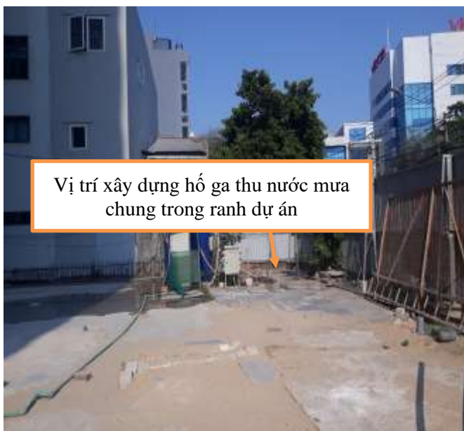
Hình 3.3. Vị trí hố ga thu gom nước mưa chung nằm trong ranh dự án
