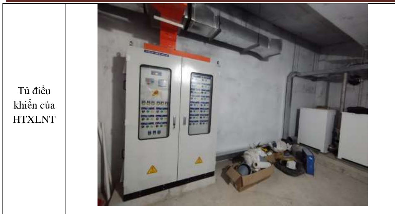
Hình 3.12. Một số thiết bị được lắp đặt trong HTXLNT
